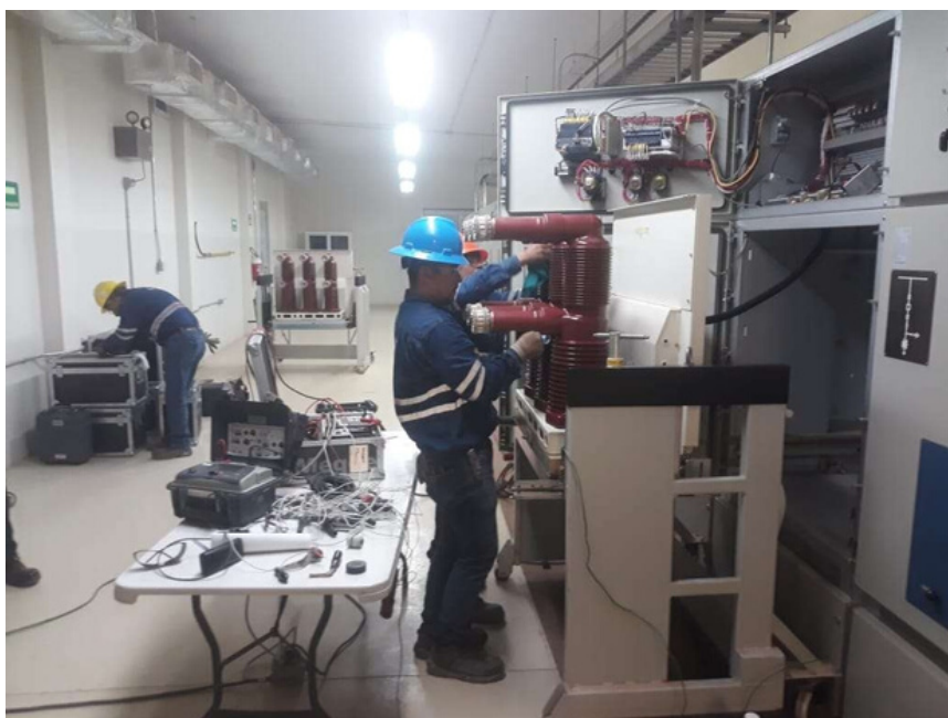
Pruebas Pre-operativas y Mantenimiento a equipos en SE Fresnillo en Mina la Herradura, Ubicada en Caborca Sonora.
